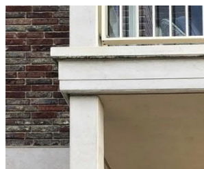
Beton balkon en kolom
