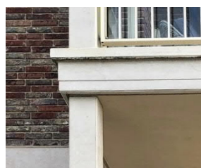
Beton balkon en kolom
